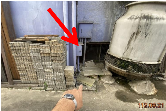
經勸導多次仍不改善，廢棄物堆置，請立即清除。
