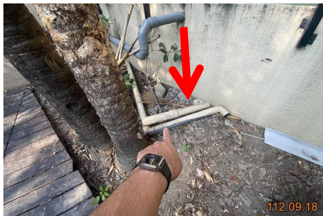
未落實自檢孳清作業，廢棄管材未清除。
